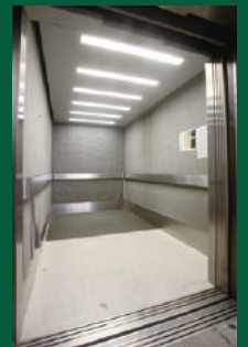
西側エレベーター(搬入用)
